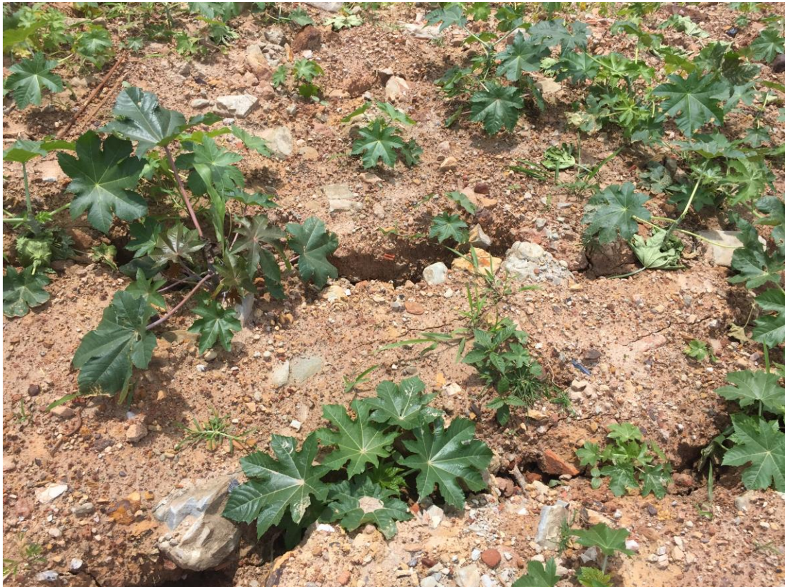
Figura 8.5: Trincas na berma do talude II, indicando uma pequena movimentação do talude.
