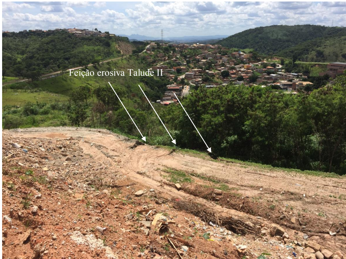
Figura 8.3: Feição erosiva instalada na face do taludê I, proveniente de percolação das águas pluviais(fonte Daniel 2016).
