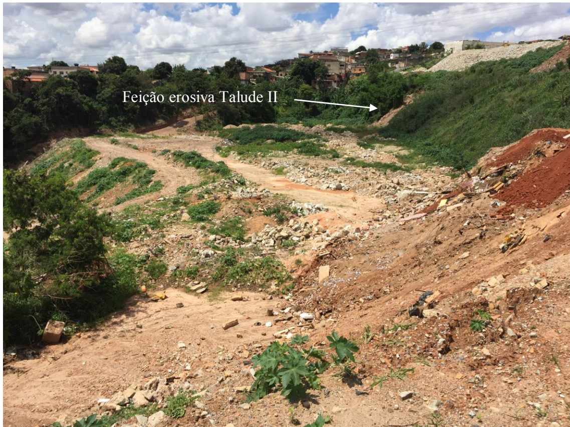
Figura 8.1: Feição erosiva instalada na face do talude II, proveniente de percolação das águas pluviais (fonte Daniel 2016).
