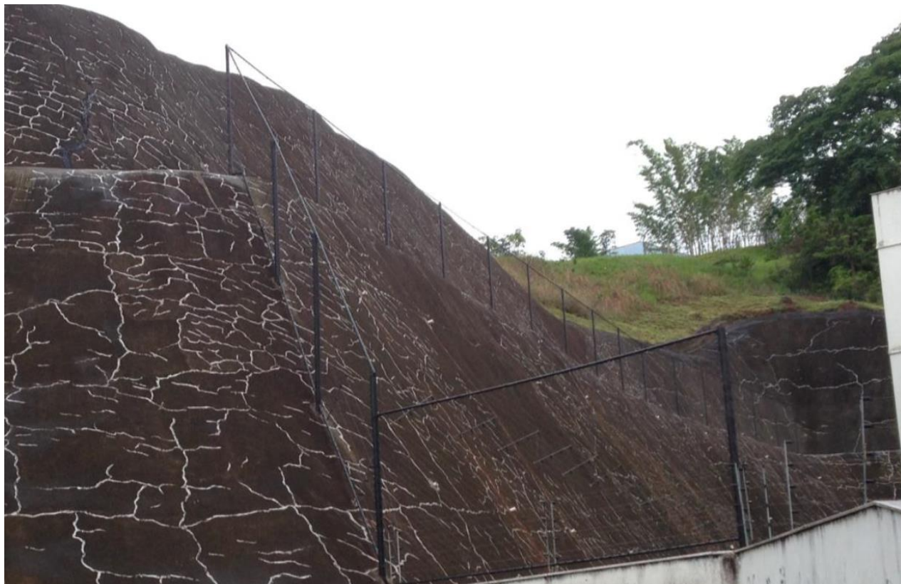
Figura 9.1: Visão geral do talude apresentando trincas em toda sua extensão.
