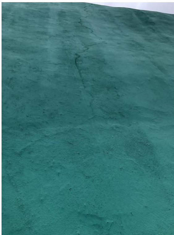
Figura 10.3: Vista Frontal do talude de jusante para montante evidenciando a trinca de fora a fora, rompendo a manta Elástico.
