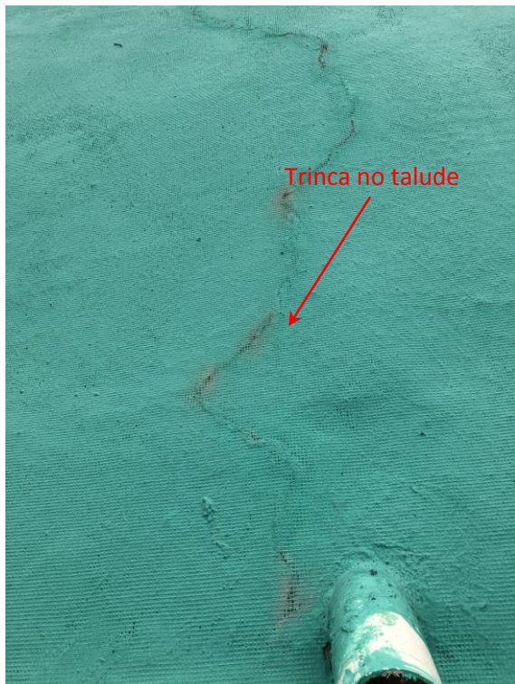
Figura 10.1: Vista da trinca no talude, rompendo a manta Elastic.
