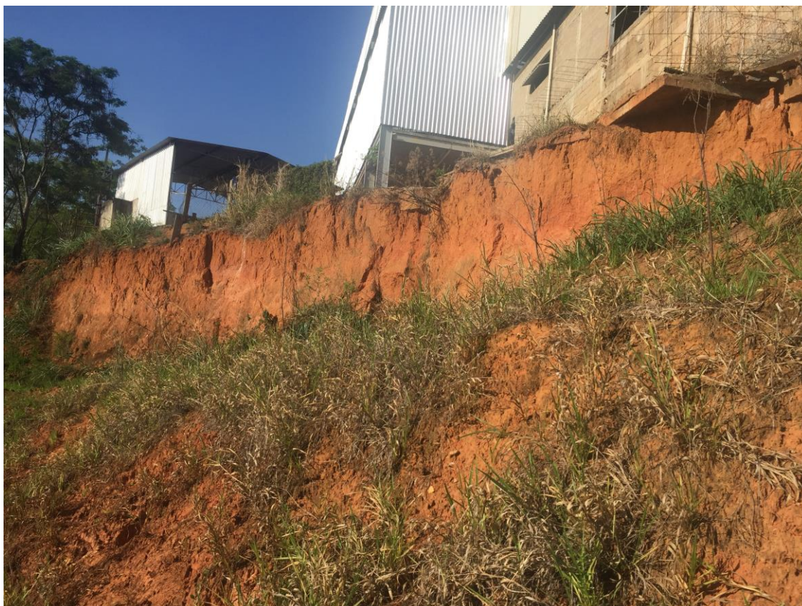
Figura 8.7: Cicatriz da cabeceira do talude, evidenciando a evolução do processo erosivo, caracterizado pelas voçorocas.
