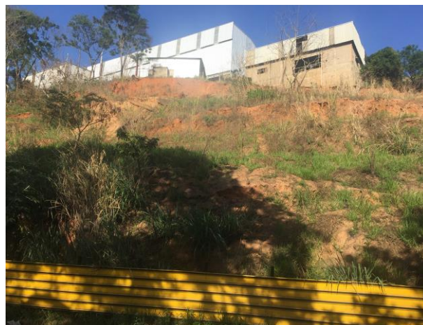
Figura 8.3: talude nas condições atuais onde é possível observar evidências da deficiência na implementação da cobertura superficial.
