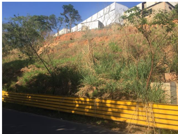
Figura 8.1: Vista frontal do talude, o que evidencia que o mesmo continua se deslocando e gerando novos rompimentos, é exatamente o posicionamento inclinado da árvore.
