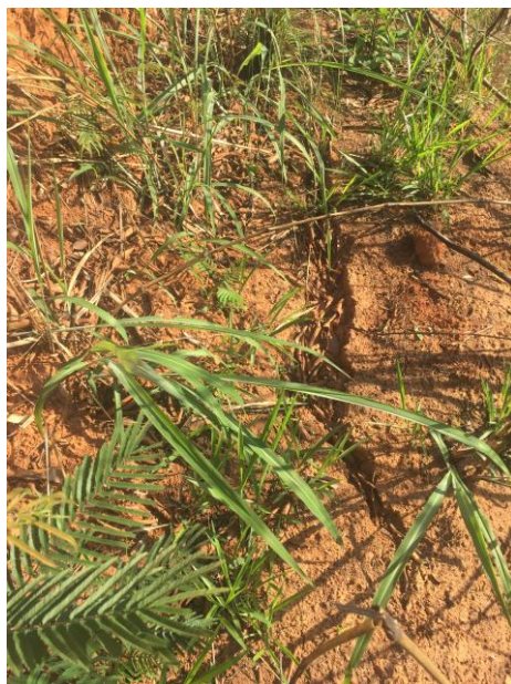
Figura 8.4: trinca recente no presente em solo exposto do talude.
