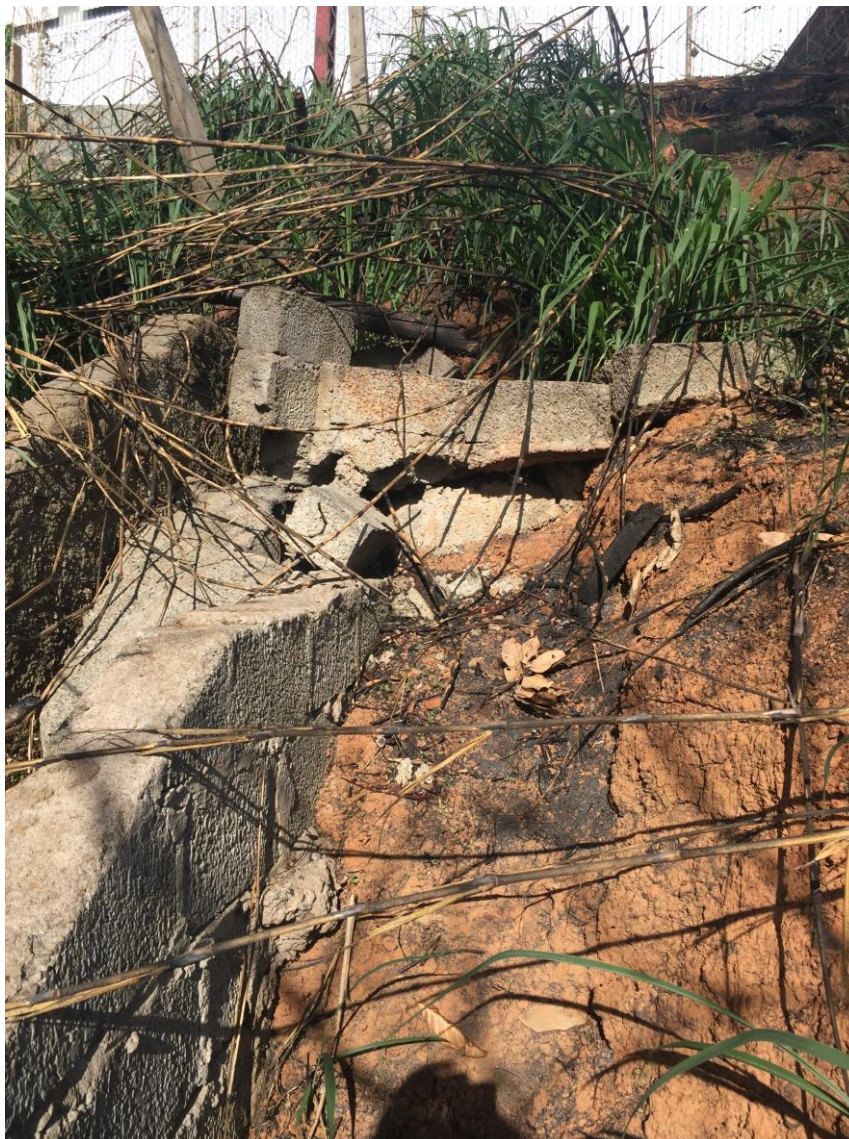
Figura 8.6: Evidência da deficiência da drenagem superficial, rompimento da escada de amortecimento.
