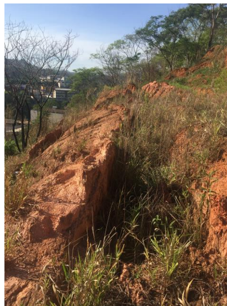
Figura 8.5: Abertura no solo proveniente de suas movimentações em função da deficiência de cobertura superficial
