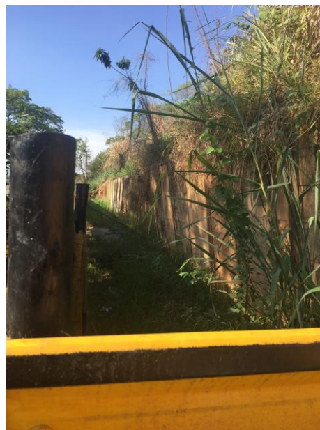
Figura 8.2: Vista lateral do pé do talude, evidenciando sua atividade em função da inclinação (barriga) presente no muro.
