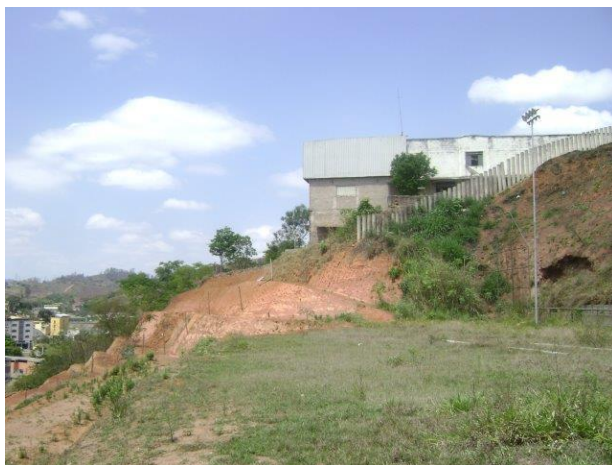
Figura 8.2: processo de retaludamento realizado em XXXXXXXXX, onde pode-se observar a total deficiência na cobertura superficial.
